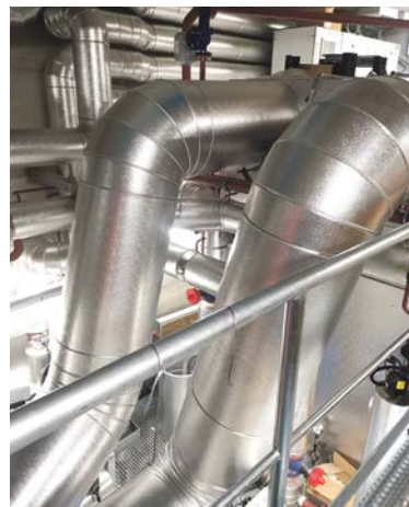
Die neue Filteranlage des Krematoriums Rüti.
